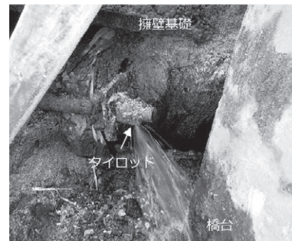
写真3 A-3被害状況
