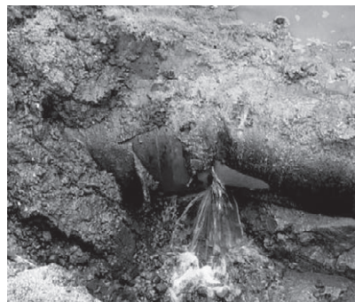
写真2 A-2被害状況
