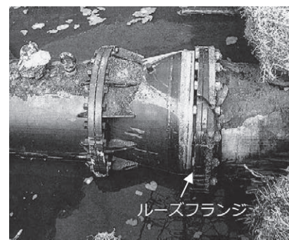
写真5 A-5被害状況
